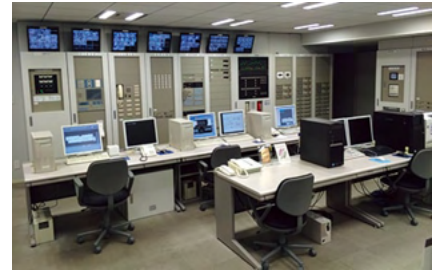
防災センター
