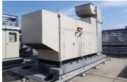
非常用電源設備
