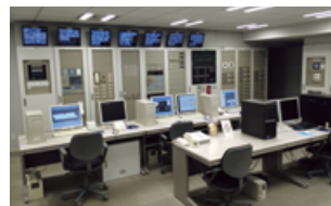
防災センター
